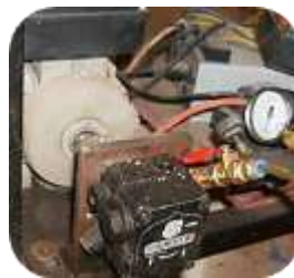
Gambar 4.5. Pompa Oli dan Motor Listrik
